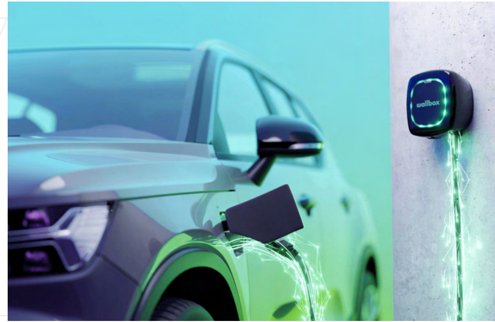
Árma ha llegado a un acuerdo corporativo con Wallbox® para implementar sus cargadores inteligentes en sus edificios.
